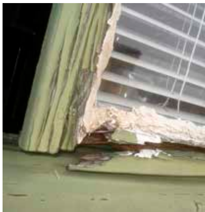
Fönster i 38an som besiktigades i februari. Skicket är för dåligt för att kunna renoveras.
